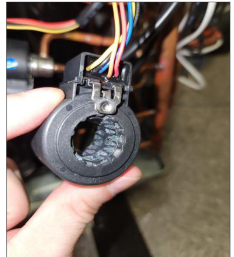
Figure 26. Retirez et inspectez la bobine de l'EEV à la recherche de rouille ou de corps étrangers
