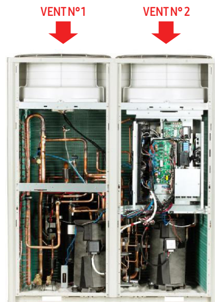
Le ventilateur n° 2 se trouve sur le côté droit de l'unité.
