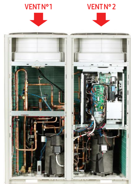
Le ventilateur n° 1 se trouve sur le côté gauche de l'unité.
